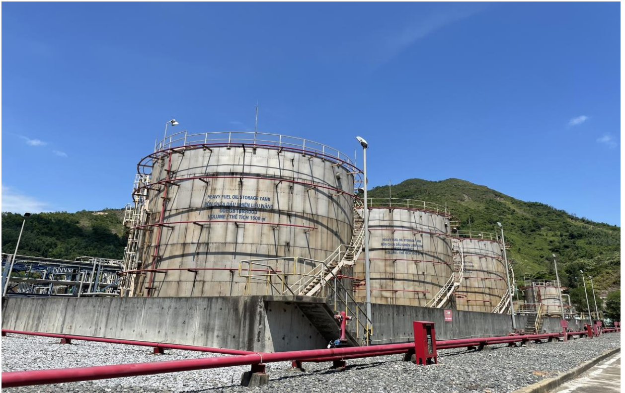
Hình ảnh: Kho xăng dầu nội bộ của Nhà máy Nhiệt điện Vũng Áng I
