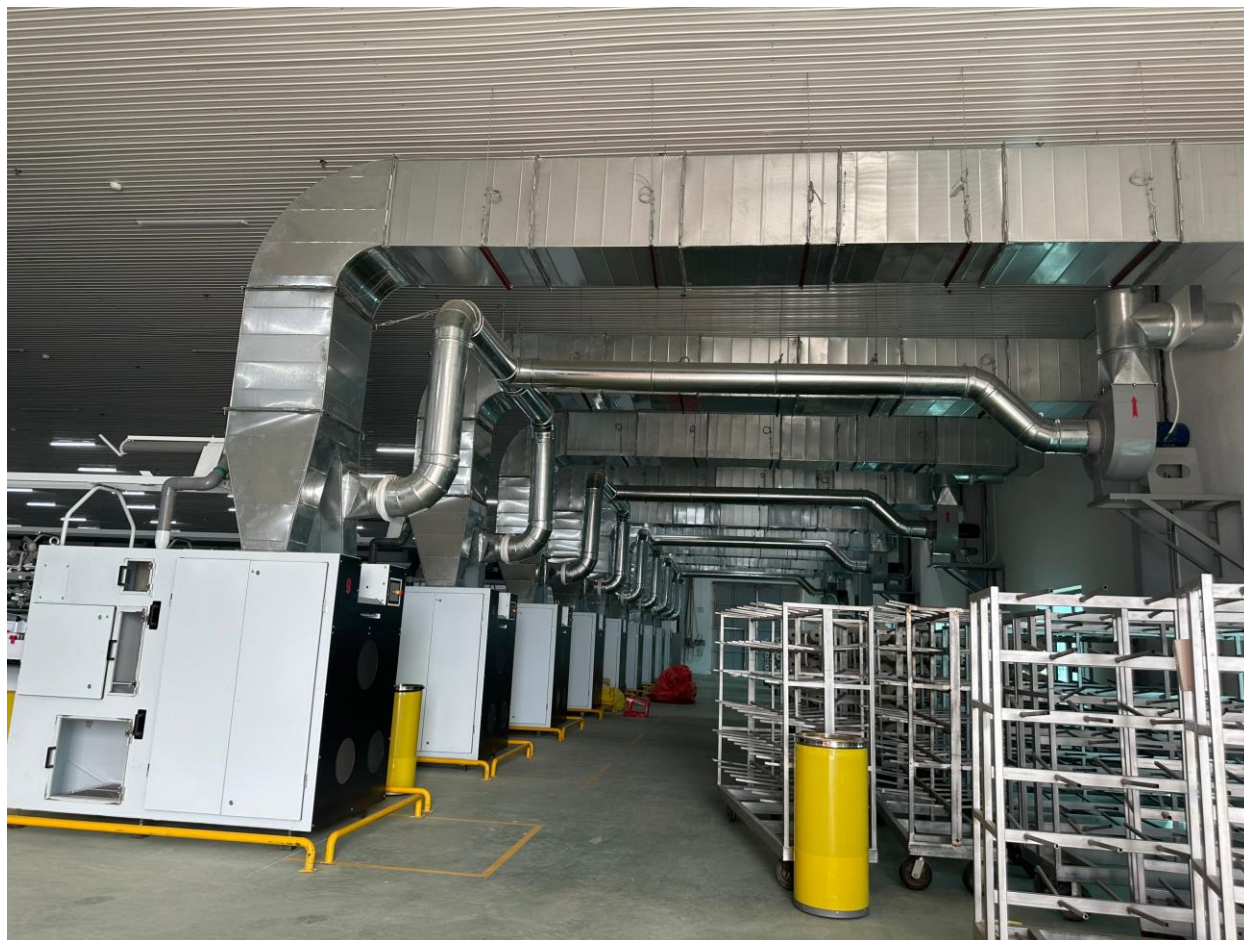
Hình 3.9. Hình ảnh máy lọc bụi tại Nhà máy
