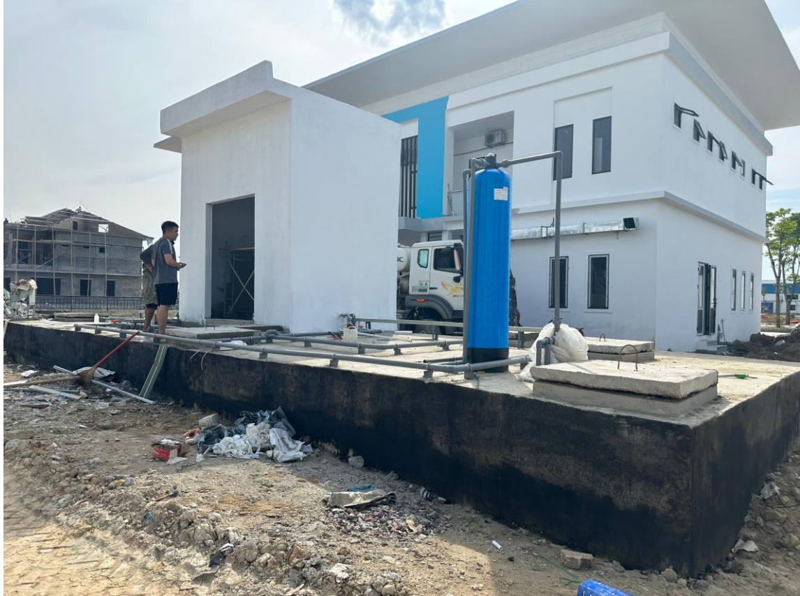
Hình 3.5. Khu hệ thống xử lý nước thải tập trung
