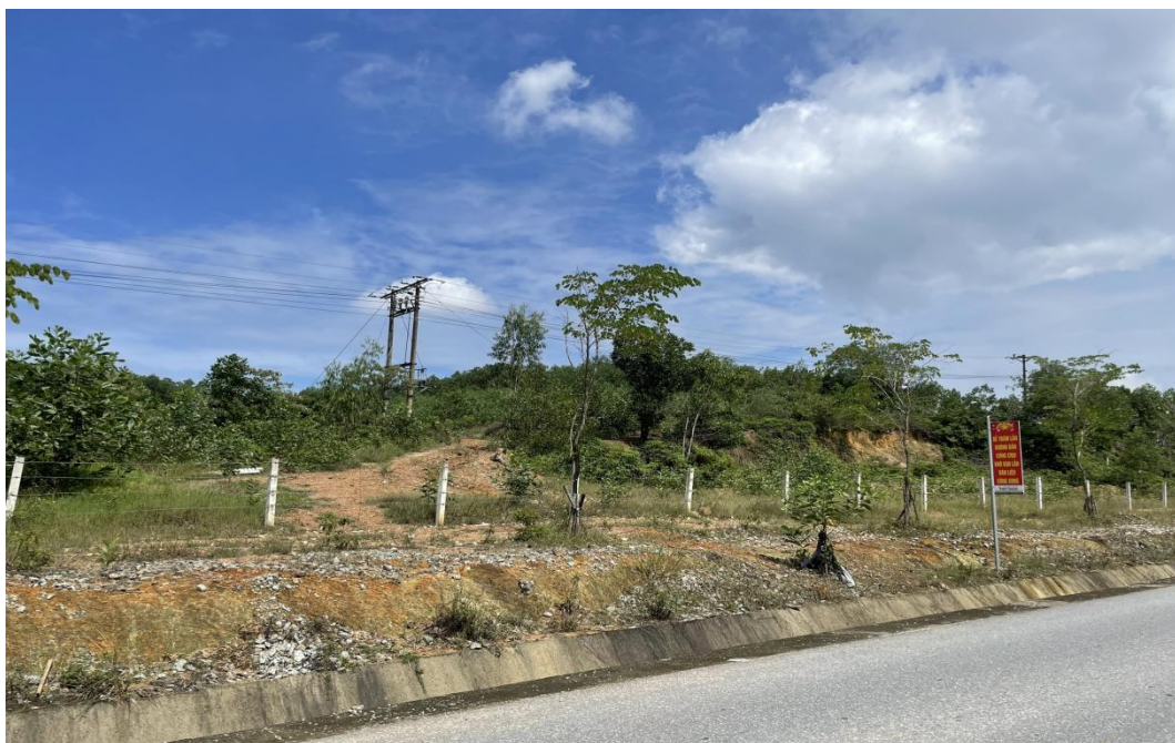
Hình 1. 35 Hình ảnh tuyến đường dây 35kV dự kiến cung cấp điện cho Nhà máy nước
