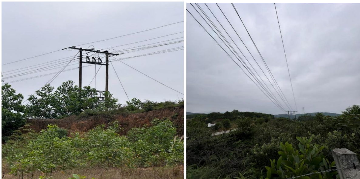
Hình 1. 9 Hệ thống đường dây điện 35kV đi qua dự án
