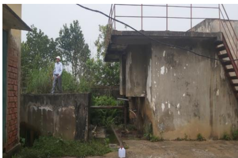
Công trình cấp nước sinh hoạt xã Kim Song Trường - huyện Can Lộc
