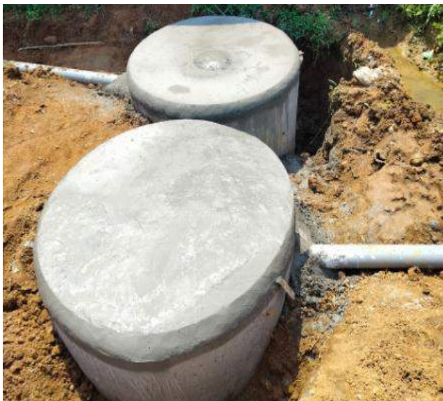
Hình 3. 3. Bể lắng lọc nước thải sau bể tự hoại
