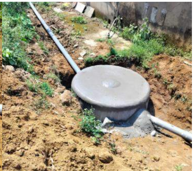
Hình 3. 4. Bể lắng lọc nước thải tại khu vực nhà ăn
