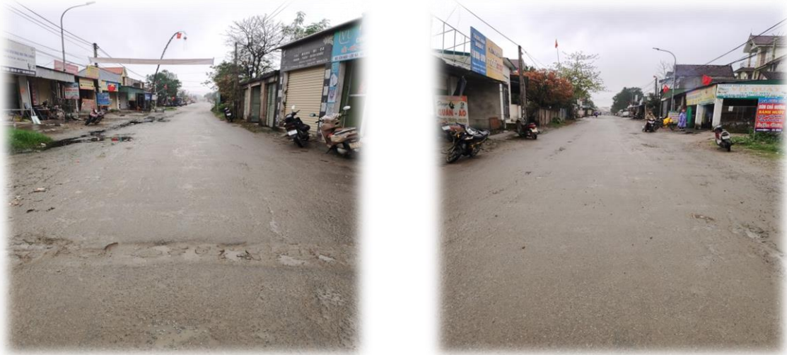
Hình 1. 2: Hiện trạng mặt đường trục xã đoạn qua khu vực dự án
