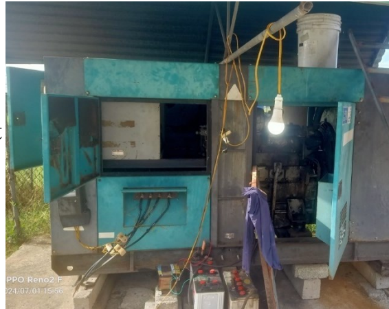
Hình 3.13. Máy phát điện
