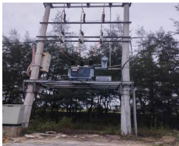
Trạm biến áp khu vực Villa Golf
