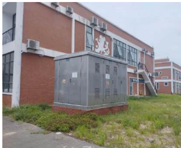
Trạm biến áp khu vực TTTM, nhà giữ trẻ, trạm y tế
