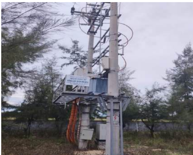
Trạm biến áp khu vực Villa Golf
