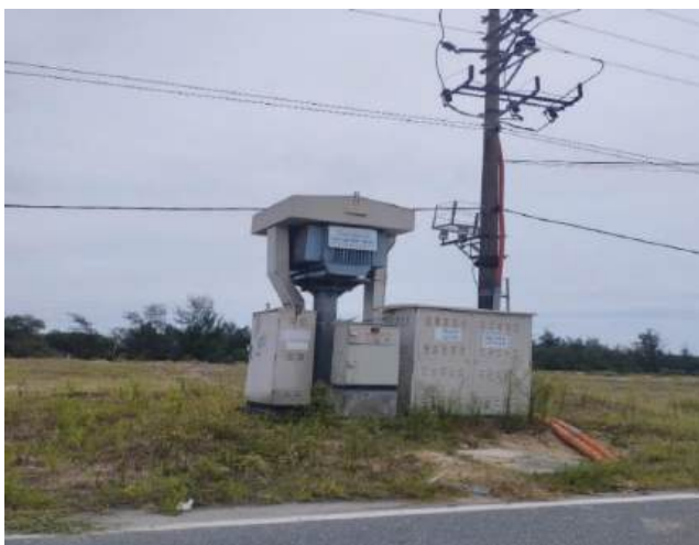
Trạm biến áp khu vực Villa Golf
