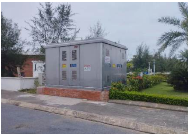
Trạm biến áp khu vực Khu Shophouse và Villa biển
