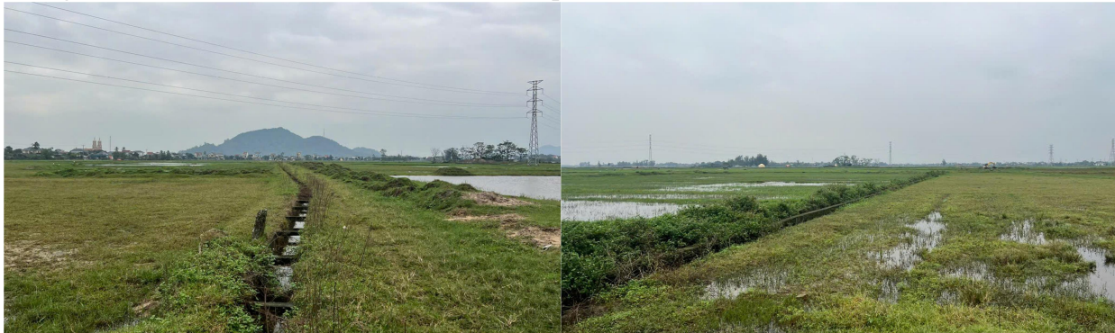
Hình 1-2: Hiện trạng đoạn mương bê tông cần hoàn trả trong quá trình thi công
