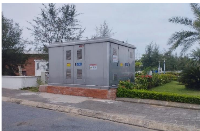
Trạm biến áp khu vực Khu Shophouse và Villa biển
