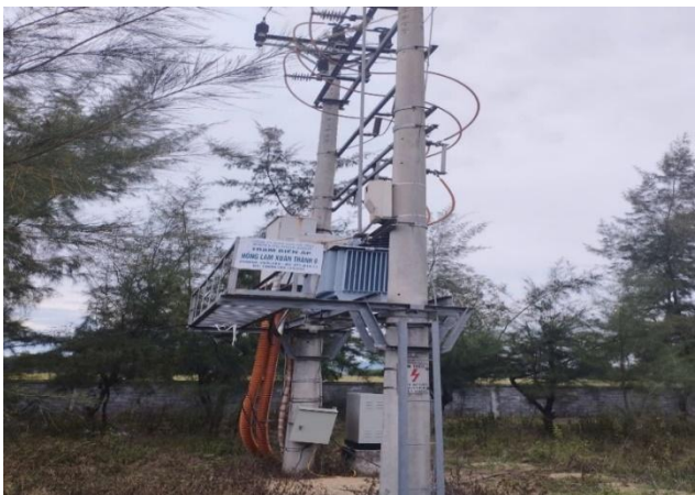
Trạm biến áp khu vực Villa Golf
