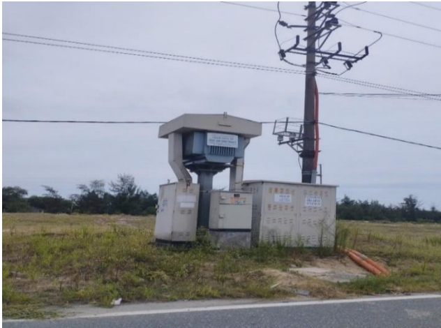
Trạm biến áp khu vực Villa Golf
