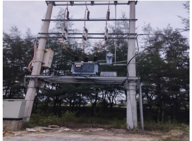
Trạm biến áp khu vực Villa Golf
