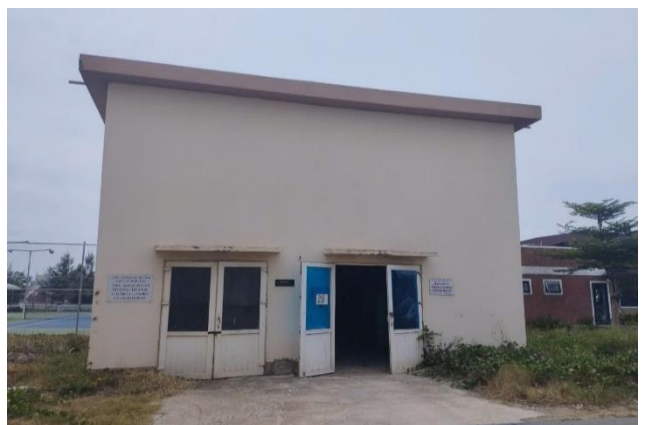
Trạm biến áp của Villa biển
