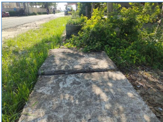
Hệ thống thoát nước dọc tuyến
