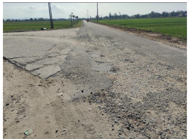
Đường hẹp, mặt đường xuống cấp
