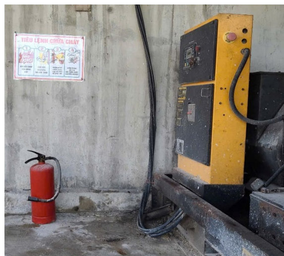
Hình 3.15. Máy phát điện 75kVA
