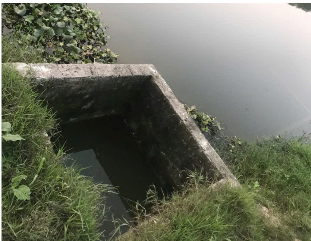
Hình 3.10. Hình ảnh hố khử trùng
