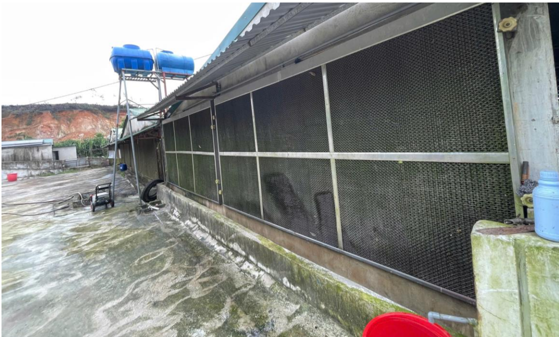
Hình 3.9. Hệ thống quạt hút được lắp đặt tại các chuồng nuôi
