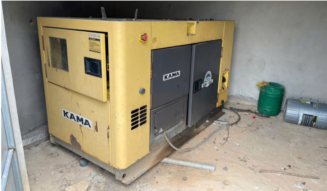
Hình 3.12. Nhà đặt máy phát điện
