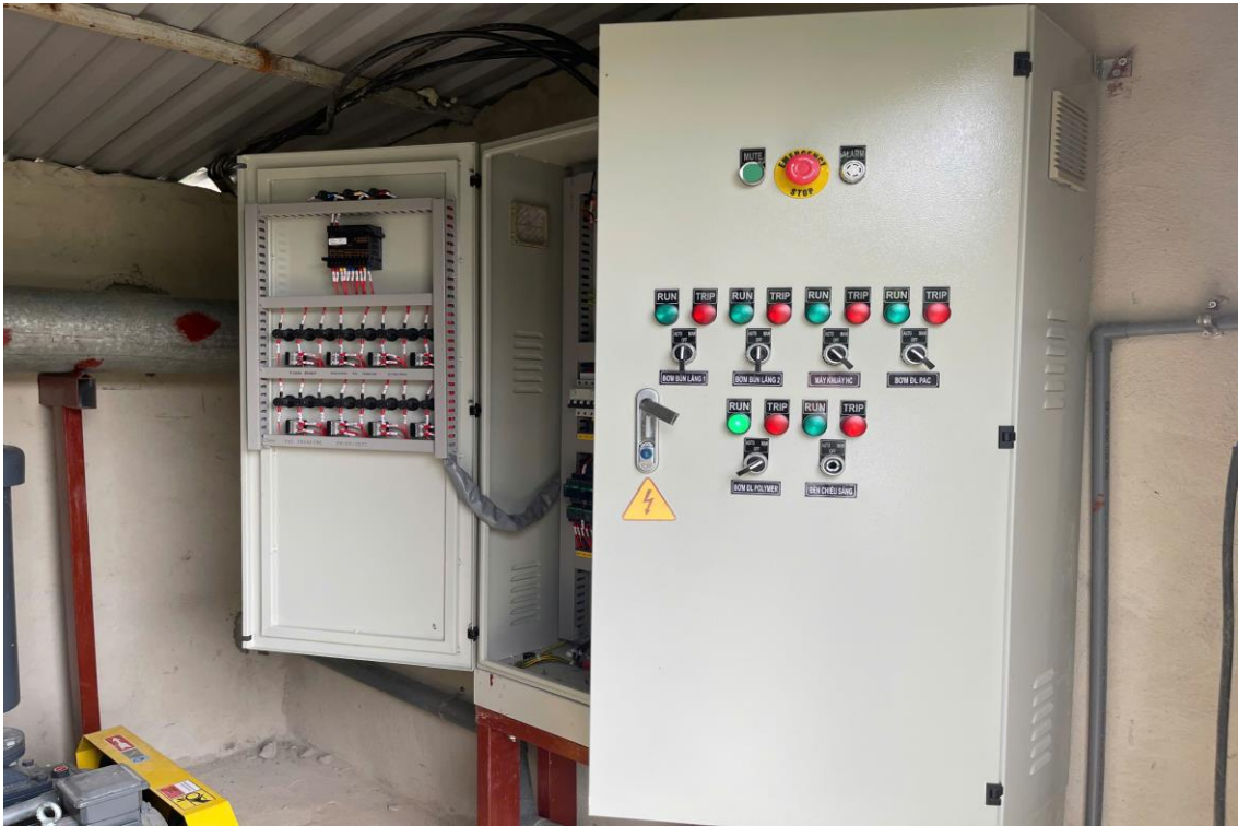
Hình 3.8. Tủ điện điều khiển Hệ thống xử lý nước thải
