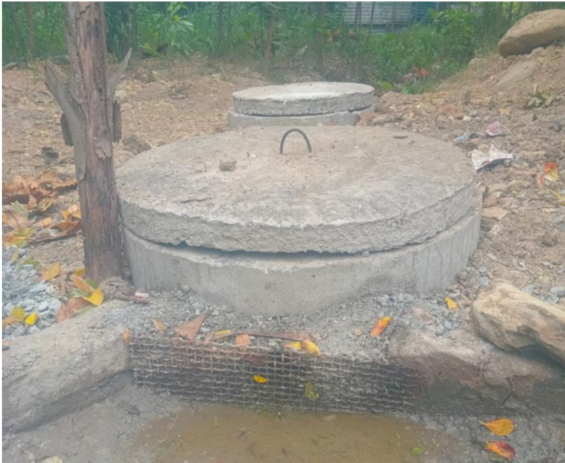
Hình 3. 5. Bể lắng lọc nước thải sinh hoạt
