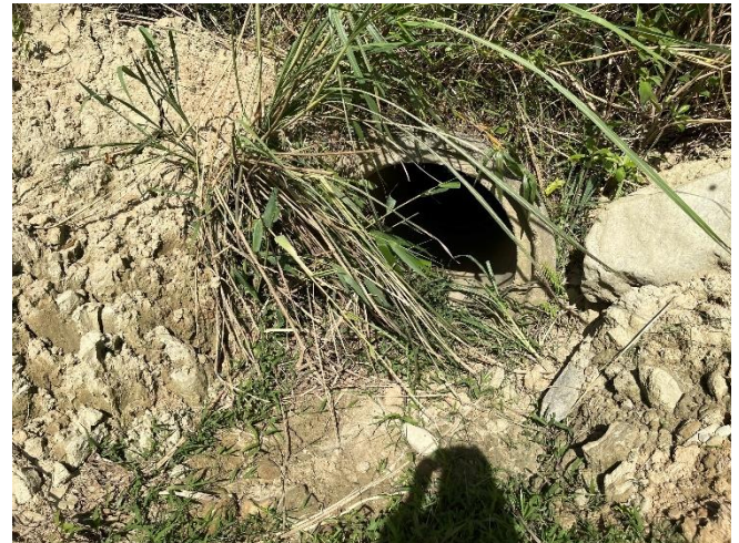
Hình 3. 3. Cổng D1m thoát nước mưa
